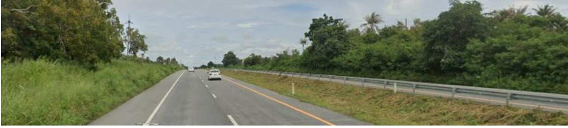
รูปที่ 5-12 สภาพทางหลวงหมายเลข 331 บริเวณ กม.12+500
