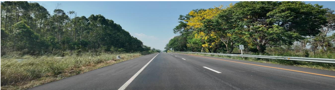
รูปที่ 5-13 สภาพทางหลวงหมายเลข 331 บริเวณ กม.11+000
