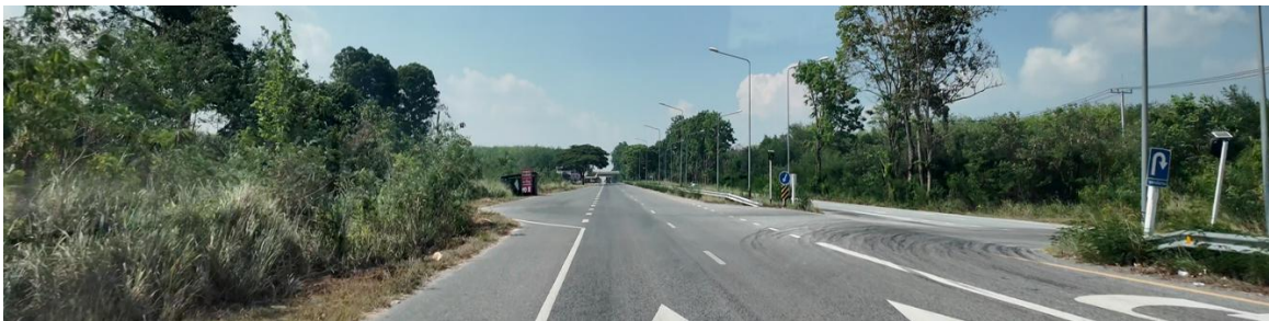
รูปที่ 5-13 สภาพทางหลวงหมายเลข 331 บริเวณ กม.12+000
